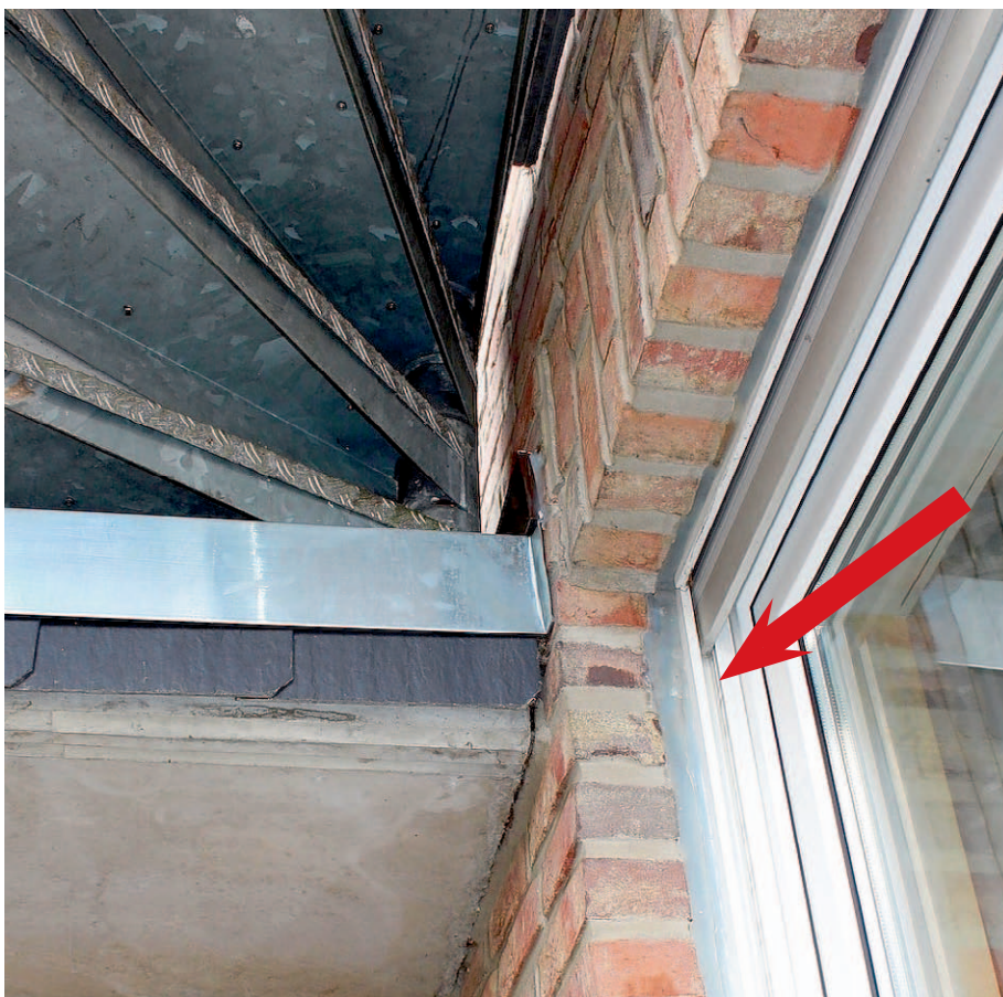
(3) Anschluss der Garage an das Wohnhaus auf der Straßenseite: Die Verblendschale ist vom Rahmen abgezogen. Ein Ebenenversatz ist sichtbar.
